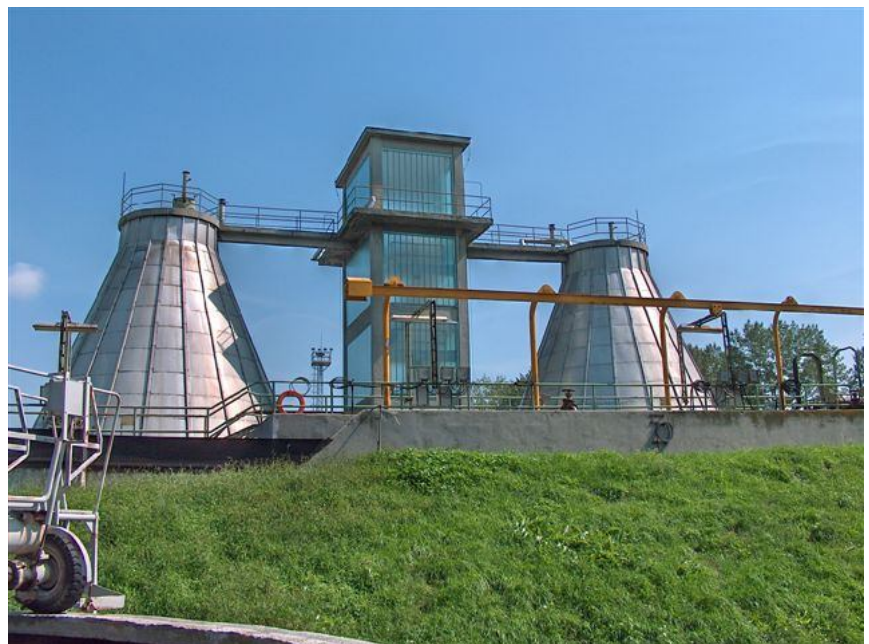
Kaposvár szennyvíztisztító telep rothasztó tornyok
