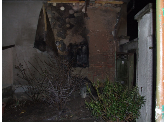
a házról leégett szigetelés
