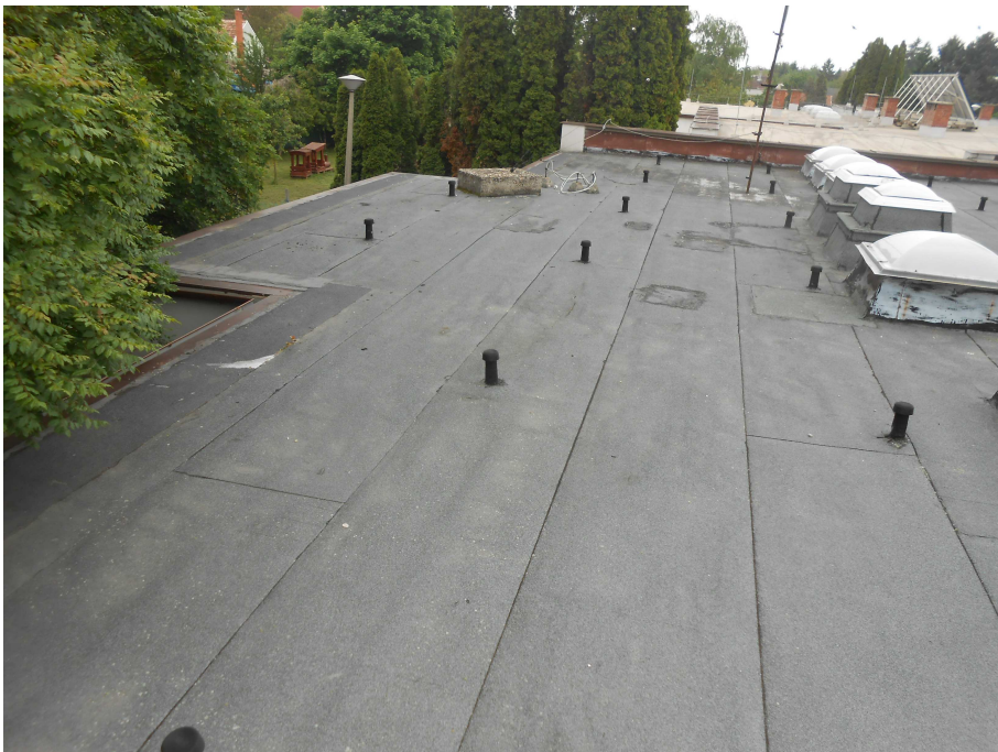
Az épületrész felújítandó lapos teteje
